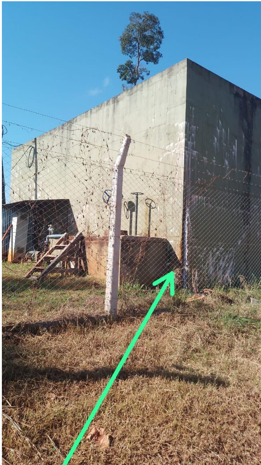
Fotografía N° 1- Obra Cisterna de almacenamiento de 3.600m 3 agua potable. Identificación de área colapsada.
