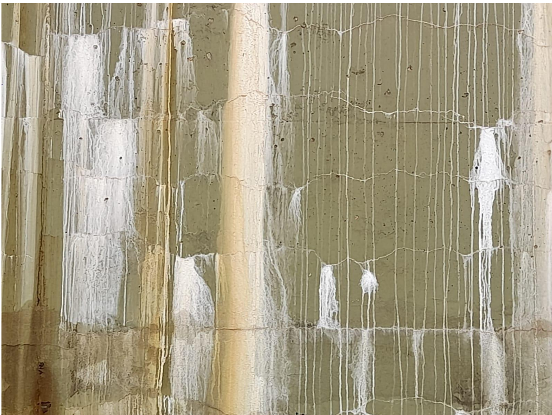
Fotografía N°3- Detalles de grietas y fisuras en estructura de hormigón.
