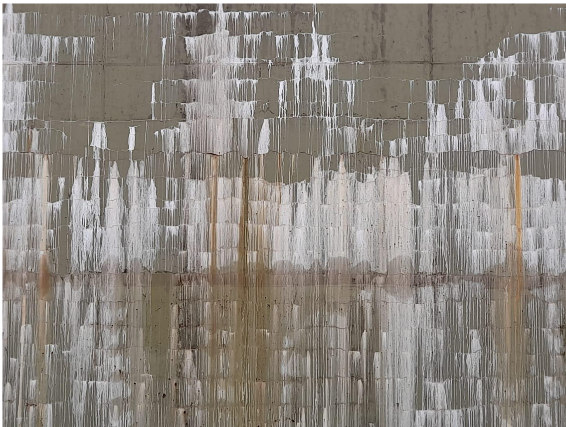
Fotografía N°4- Detalles de grietas y fisuras en estructura de hormigón.
