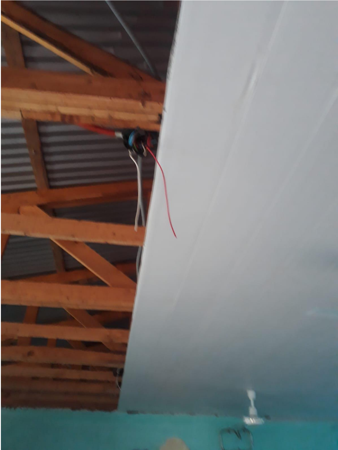
Fotografía N° 2- Detalle de cielorraso, estructura de techos, instalaciones eléctricas con cables suspendidos con riesgo de electrocución.
