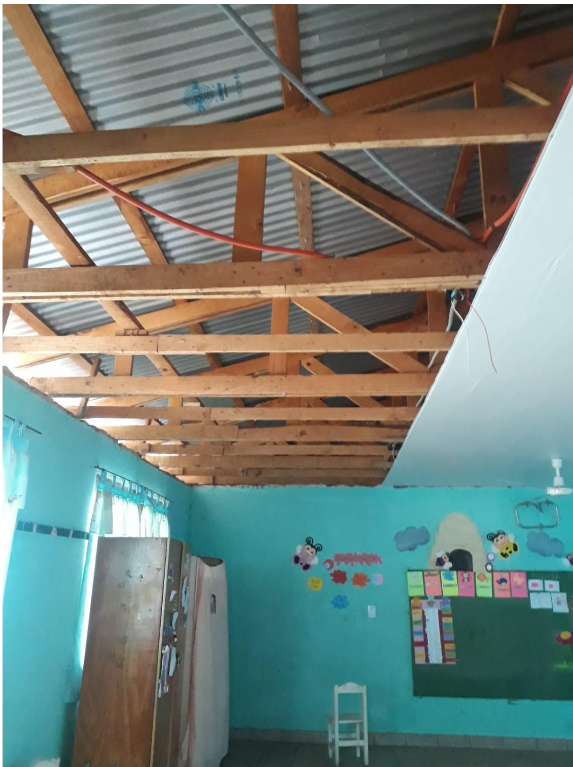
Fotografía N° 3- Estado cubierta de techo – no se observa aislación acústica y térmica, se detecta en la instalación eléctrica, caños corrugados, que no cumplen con la normativa específica para instalaciones eléctricas en establecimientos escolares.
