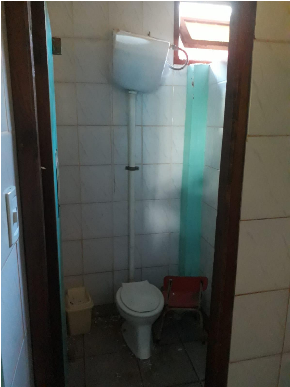
Fotografía N° 4- Estado actual de sanitarios.
